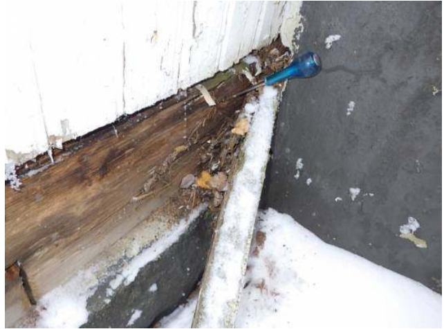
19. Kuistin seinän alaosat lahonneet molemmissa kuisteissa
