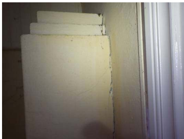
31. Edellisen kuvan tulisija kallistunut irti seinästä
