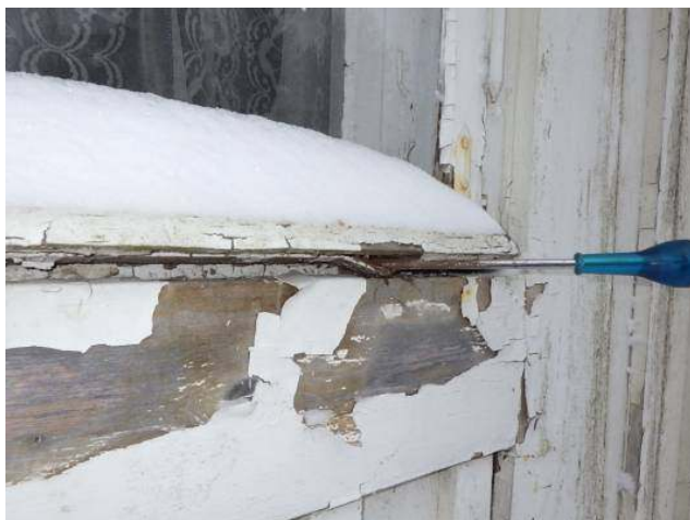
22. Ikkunoiden maalipinta hilseilee
