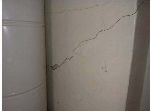
33. Lähikuva palomuurin halkeamasta.
