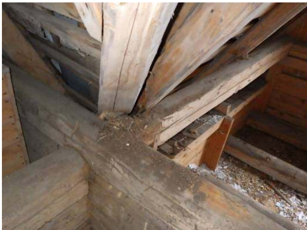
16. Korjaamaton lahovaurio katon jiirin kohdalla ullakolla
