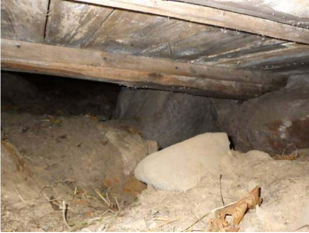
7. Selkeää silmin havaittavaa mikrobikasvustoa alapohjan alapinnassa.
