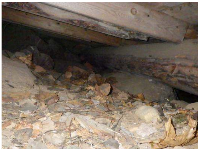
3. Paikoin alapohjan puurakenteet ovat lähes maassa kiinni
