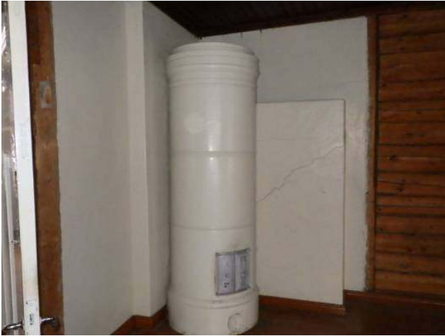
32. Palomuurin toisella puolella oleva pystyjuuri kallistunut ja palomuurissa halkeama
