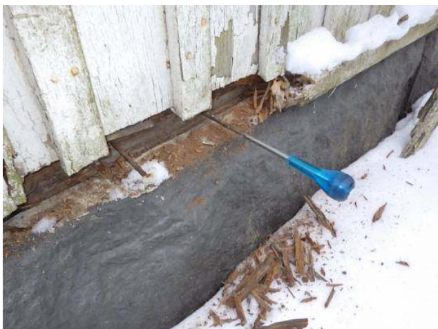
14. Paikallisia vaurioita alimmassa hirsikerrassa
