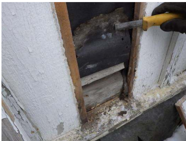
13. Paikallisia vaurioita alimmassa hirsikerrassa
