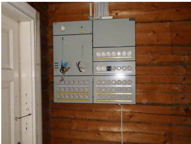
35. Mittaritaulu, mittari poistettu.
