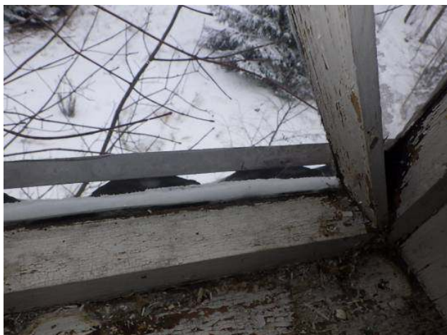
26. Kattolyhdyn ja katteen liittymä kuvattuna ullakon ikkunasta, vesi pääsee suoraan profiilipellin alle
