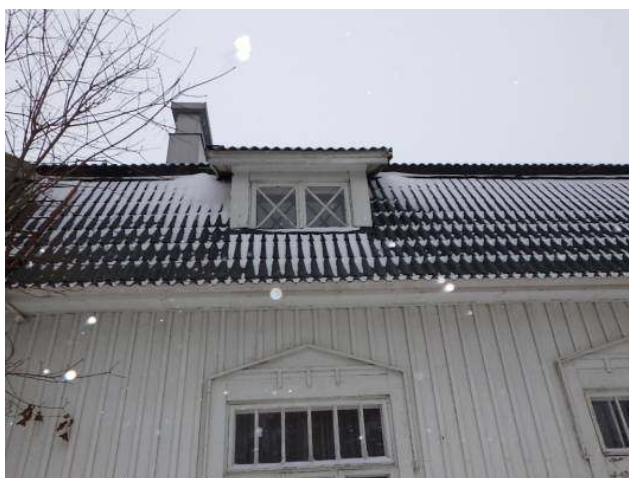
25. Kattolyhtyjen kohdalta puuttuu ylösnostot.
